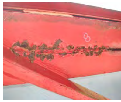
B水管橋トラス弦材の腐食
