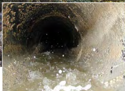
管内部の腐食
