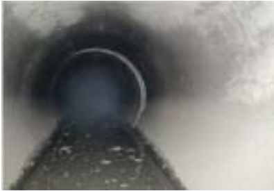
写真 - 2 管内状況 腐食・劣化は認められない 継ぎ手部のずれあり
