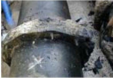
写真 - 1 外観状況 ボルト・ナットの腐食
