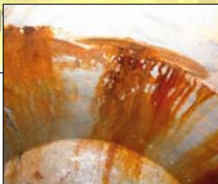
マンホールの水平ひび割れ
