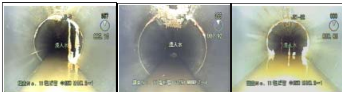
水洗い前の接合部からの漏水
